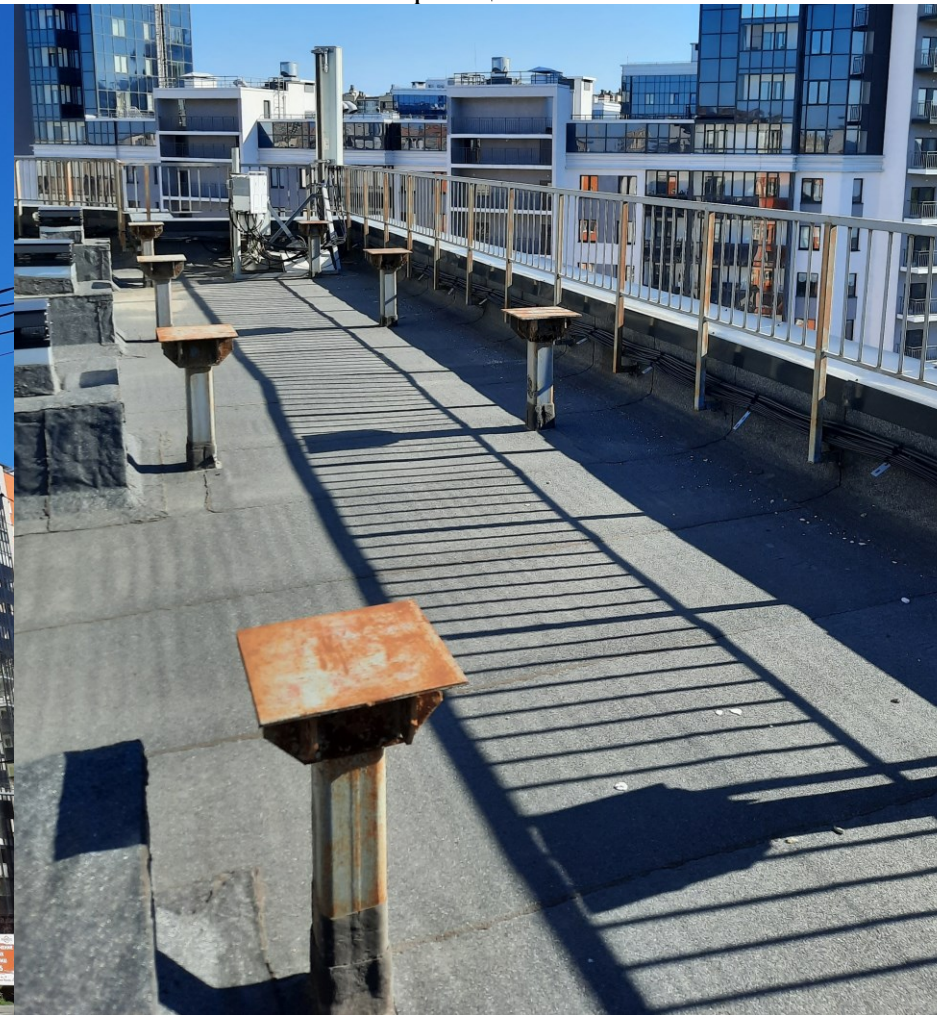
Фото закладных предусмотренных и установленных застройщиком
